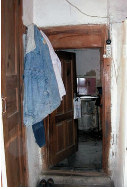
Res.18- Mutfak kapısı
