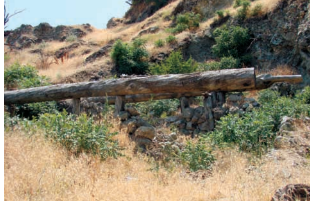
Res.8- Köyde yıkık durumdaki konutlardan bir örnek
