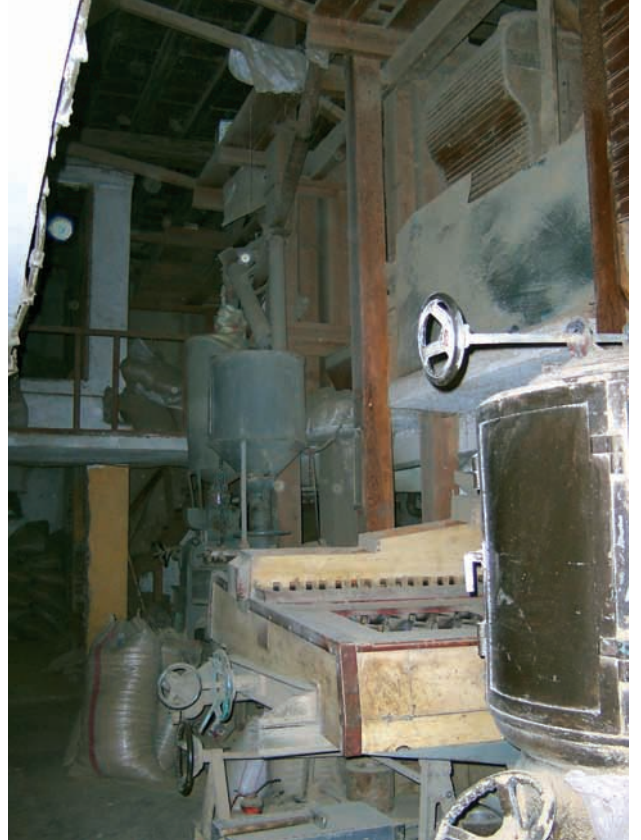
Res.29- Şamlılar Çeltik Fabrikası, Üretim-1 mahalli
